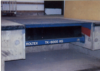
Перегрузочный мост в исходном положении.
